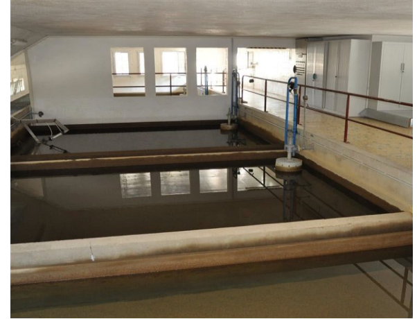
Bassins de filtration à la station d'Autun
